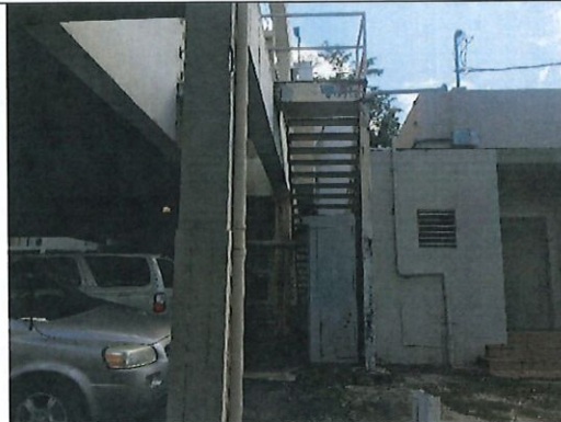
Foto 50. Poste de escalera con LBP.
