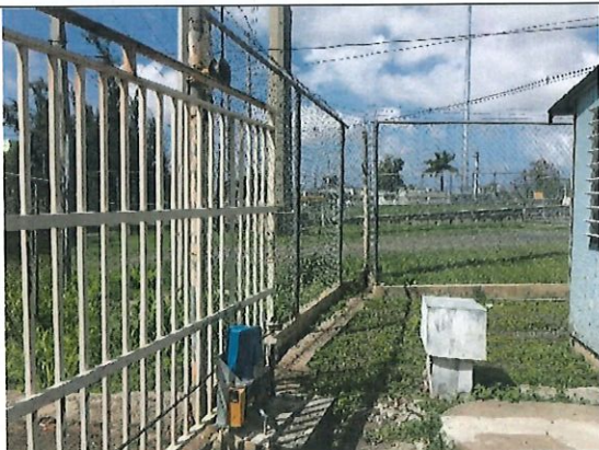
Foto 61. Poste con LBP (4) en portón de entrada Área Sur.
