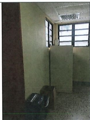
Foto 31. LBP en pared de concreto en Oficina 128
