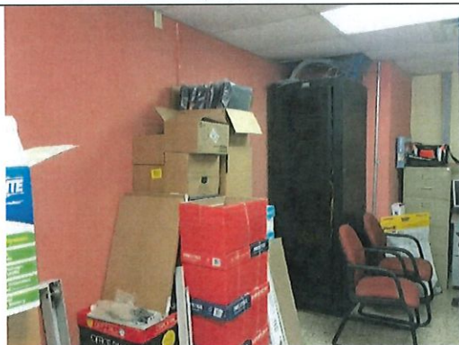
Foto 33. LBP en pared de concreto en Oficina 128
