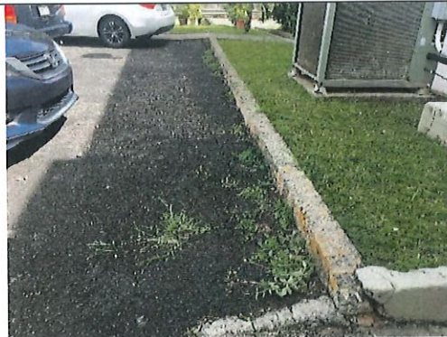
Foto 64. de encintado con LBP amarillo en estacionamientos. Área Sur Este.
