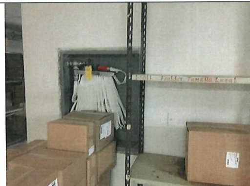
Foto 52. Caja de "Fire Station" con LBP.
