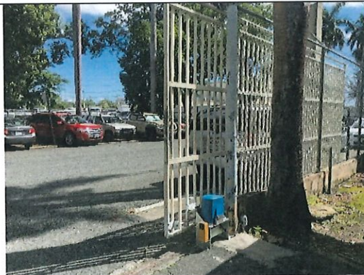
Foto 66 Poste de portón con LBP amarillo en estacionamientos. Área Norte.
