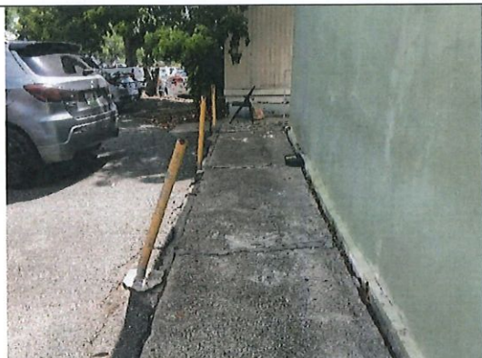
Foto 55. (5) Bolardos y (5) Wheel stop, con LBP en área de Pabellones.
