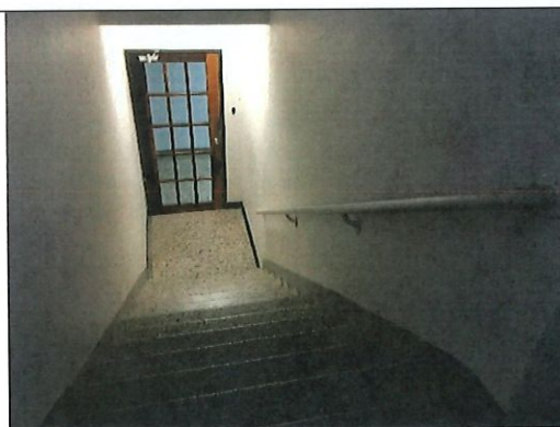
Foto 42. Escalera hacia sótano. LBP en reja y pasamanos.
