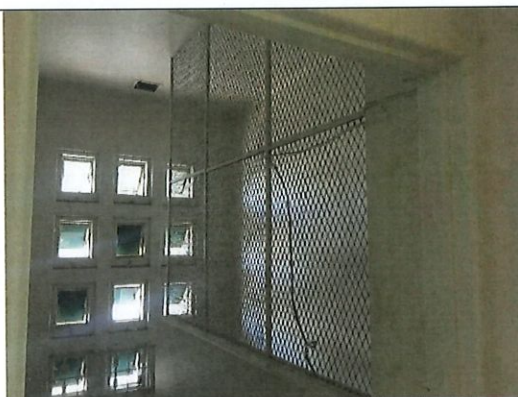
Foto 40. Escalera hacia sótano. LBP en reja y pasamanos.
