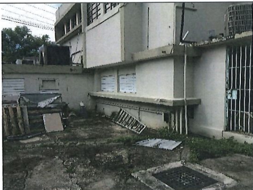
Foto 37. LBP en "Exterior Eave", Area Sur, Subestación Eléctrica y Salud.
