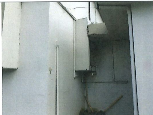
Foto 38. LBP en "Exterior Eave", Area Sur, Subestación Eléctrica y Salud.
