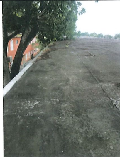
Foto 30. Roofing Material deteriorado
